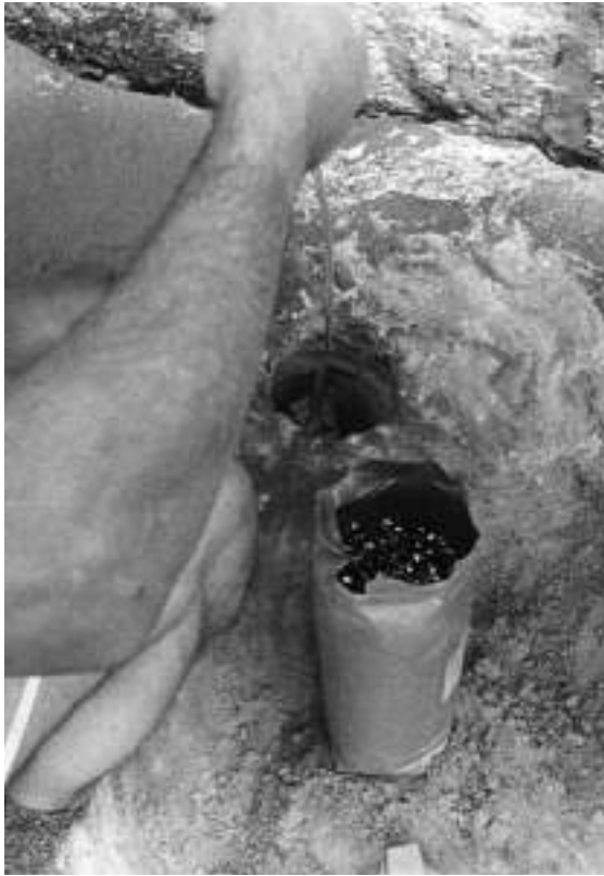
Confezionamento della carica detonante.
